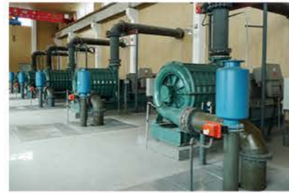
上海南汇污水处理厂
